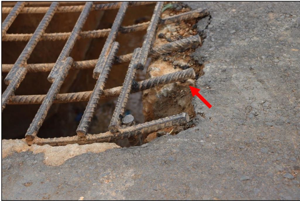
Figura 10 - O cobrimento executado para a fixação das barras foi danificado. Nota-se que algumas barras não estão apoiadas no pavimento, deformadas pela passagem de veículos.
