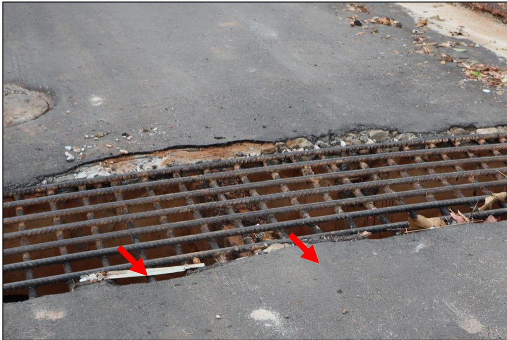
Figura 12 – Pavimento próximo a canaleta de drenagem da rua Corinto está danificado e se desprendendo.
