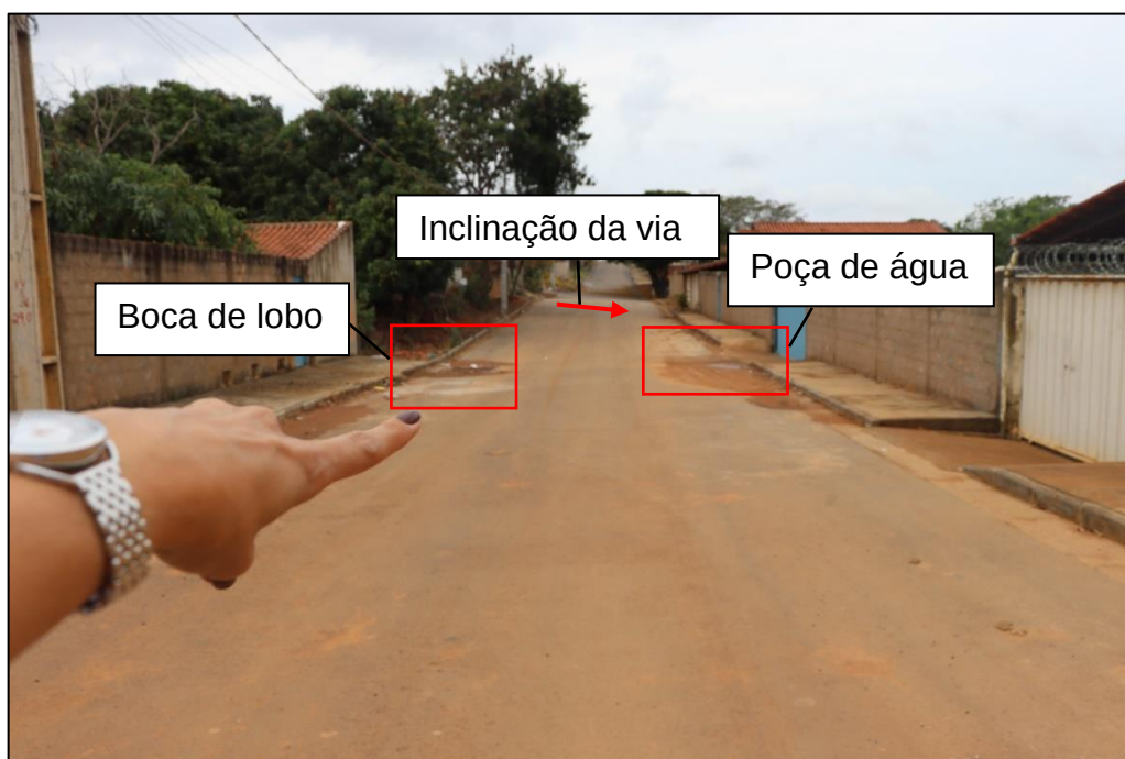
Figura 28 – Vista da rua Bocaiúva. Nota-se empocamento de água no lado contrário à localização da boca de lobo, indicando que a inclinação da via não favorece a coleta da água pluvial, que se acumula no ponto destacado à direita da imagem.
