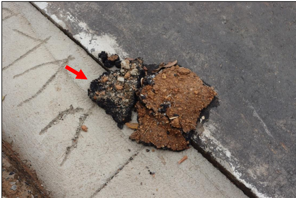
Figura 31 - Fragmentos da pavimentação asfáltica desprendidos pela chuva e diferença de nível entre a sarjeta e o pavimento asfáltico.
