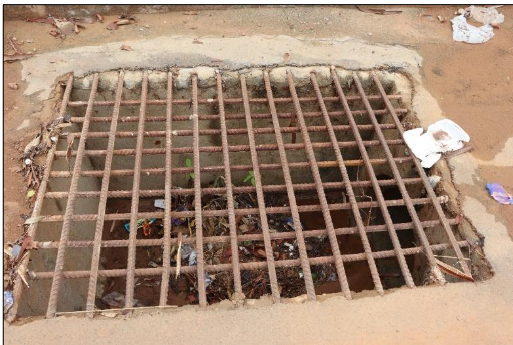
Figura 93 – Caixa coletora tamponada com grelha em barra de aço na rua Bocaiúva. Imagens da diligência de 22 de setembro.
