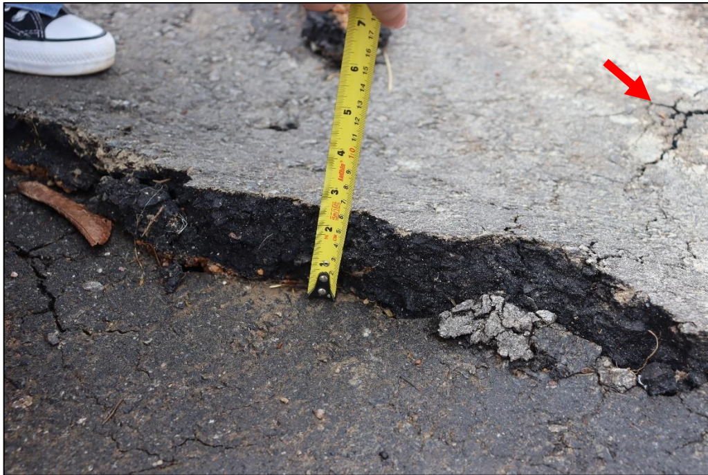
Figura 35 - Diferença das extremidades do pavimento fissurado é de aproximadamente 6,5 cm. Observa-se outras fissuras no pavimento localizadas na lateral direita da imagem.
