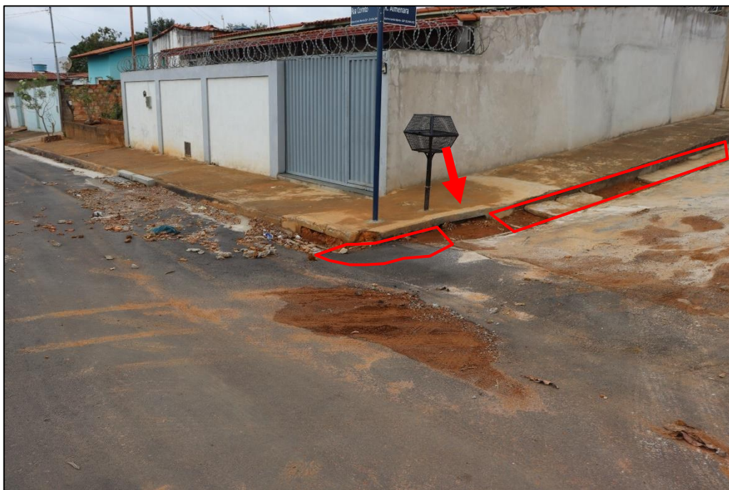
Figura 22 – Vista ampla do local da figura anterior. Sinais da existência de uma boca de lobo tamponada pela terra e descontinuidade da sarjeta da rua Almenara.
