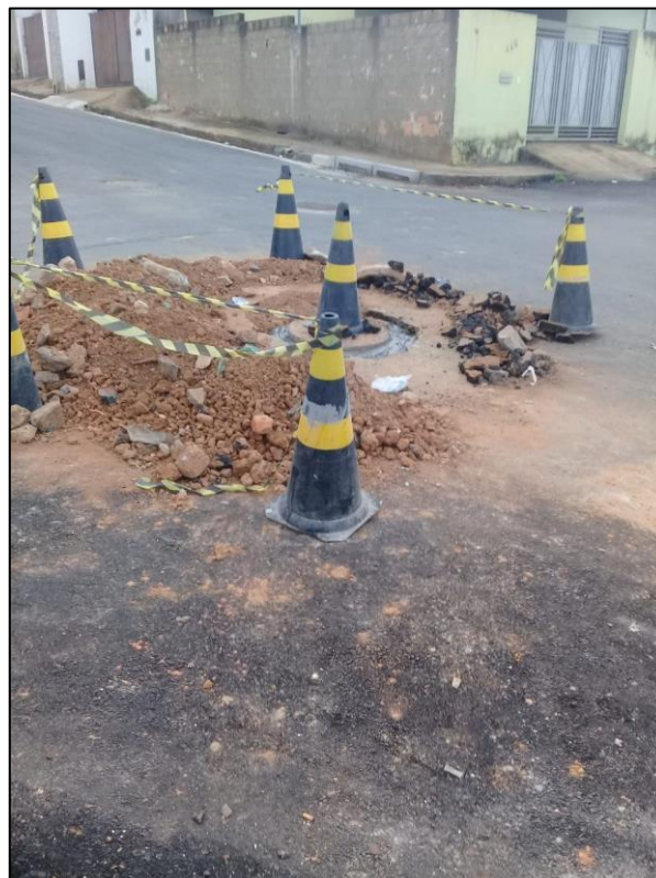
Figura 71 - Tampa de poço de visita interditada para execução de manutenções. Nota-se que o pavimento asfáltico recém executado no entorno da tampa foi removido.
