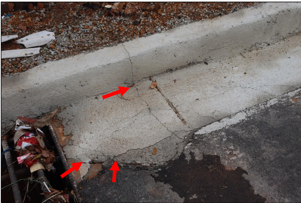
Figura 42 - Fissura no meio-fio que se estende até a sarjeta.
