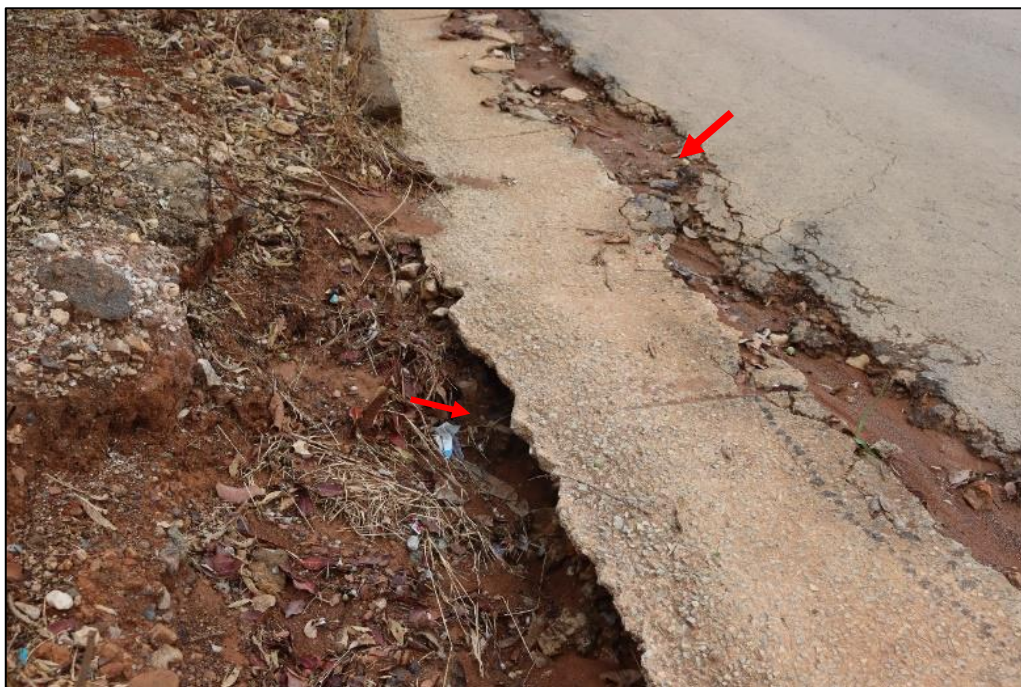
Figura 79 – Ausência de meio-fio, separação da sarjeta e desprendimento de material de base nas sarjetas. Imagem capturada na data da diligência.
