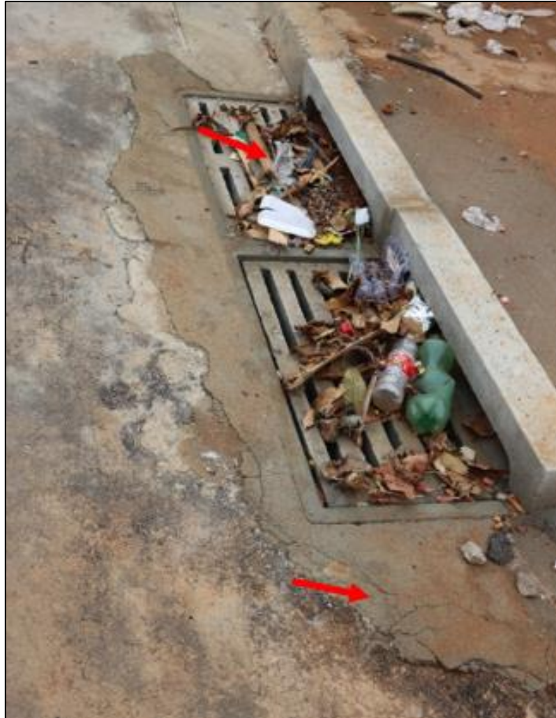
Figura 86 – Irregularidades na execução da depressão próximo a boca-de-lobo, fissuras no concreto e presença de resíduos. Fonte: Diligência 22 de setembro.
