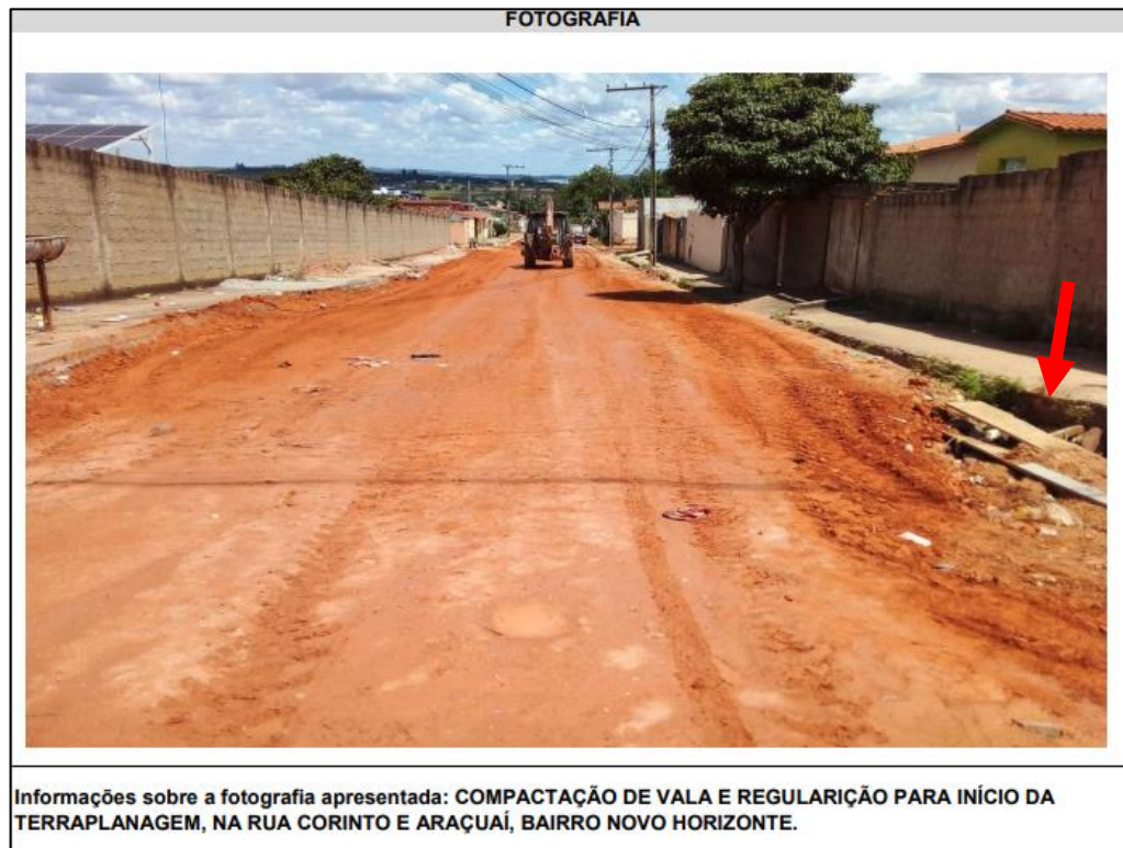
Figura 113 – Execução da etapa de regularização da vala. Observa-se ausência de compactação e presença de entulhos no local destacado. Fonte: relatório fotográfico da terceira medição da adesão 09/2021 em 03/05/2022.
