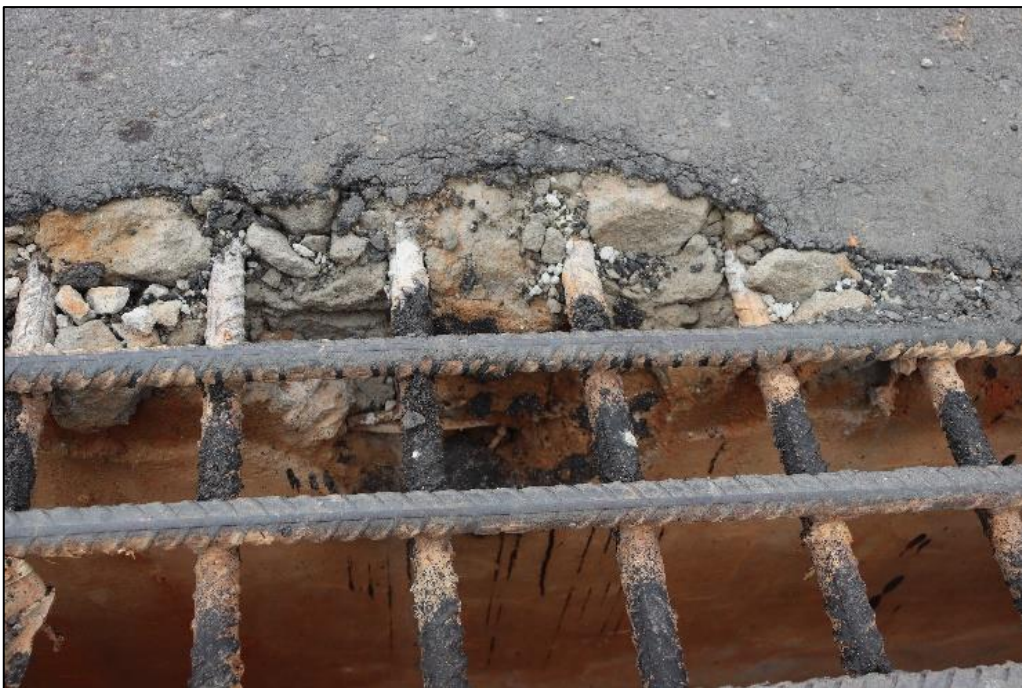
Figura 91 – Fixação danificada das barras de Ø 25 mm. Imagens da diligência de 22 de setembro.
