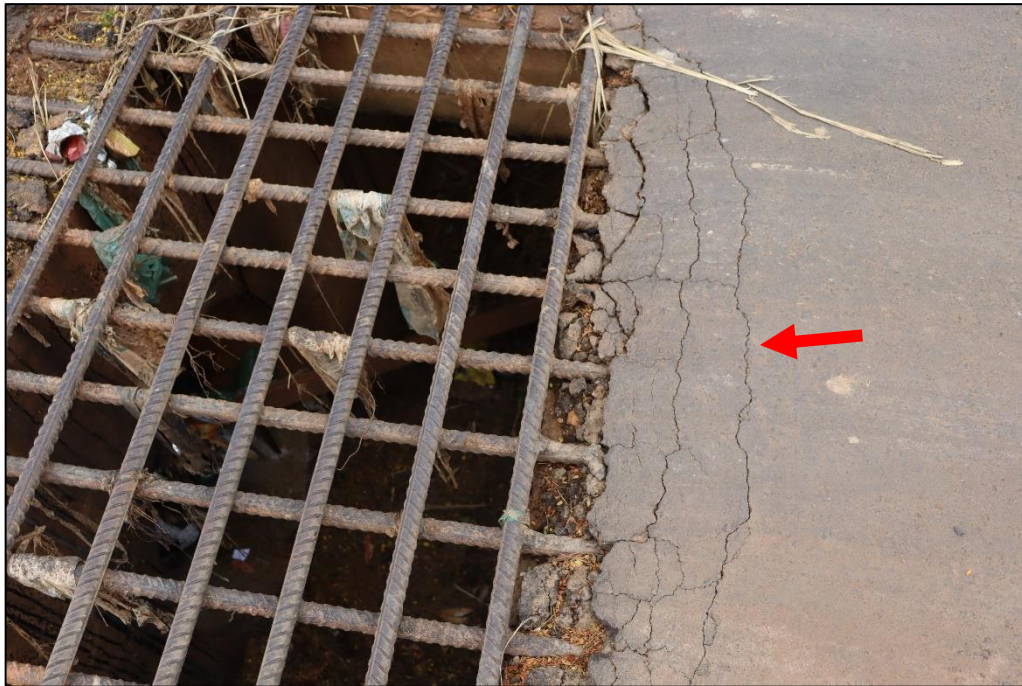
Figura 13 - Fissuras no pavimento próximo à fixação da grelha da canaleta devido a movimentação de veículos no local. Acúmulo de resíduos nas ferragens da grelha.
