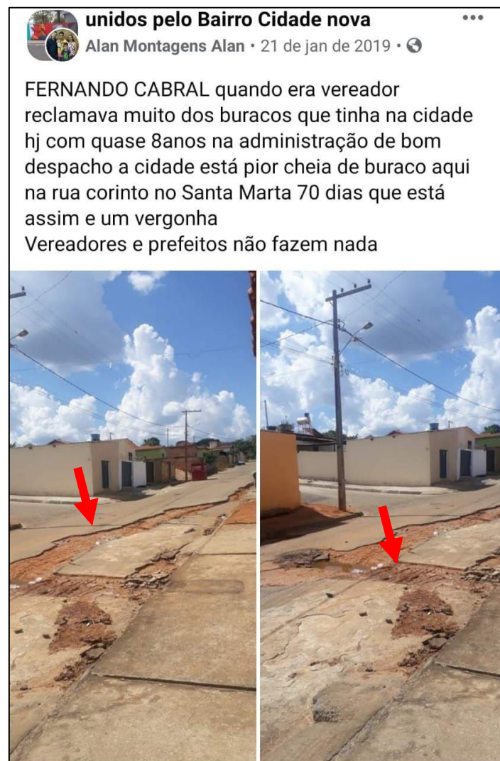
Figura 72 - Reportagem de 21/01/2019, tratando da situação da rua corinto no período informado. Observa-se que o revestimento asfáltico está ausente em algumas partes.
