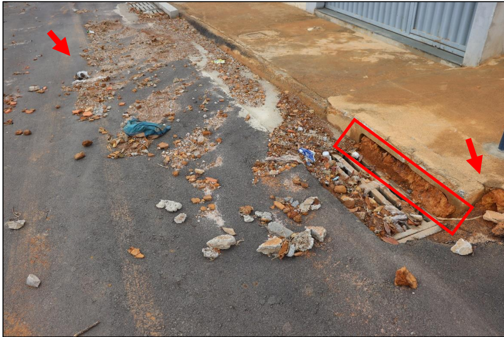
Figura 21 – Entulhos na pavimentação asfáltica e grelha da boca de lobo, fratura no meio-fio, existência de terra entre o meio-fio e grelha da boca de lobo.
