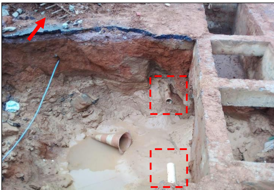
Figura 54 – Tubos descontinuados na vala. Fragmentos de grelha metálica. Fonte: relatório fotográfico da segunda medição da adesão 09/2021 em 24/12/2021.
