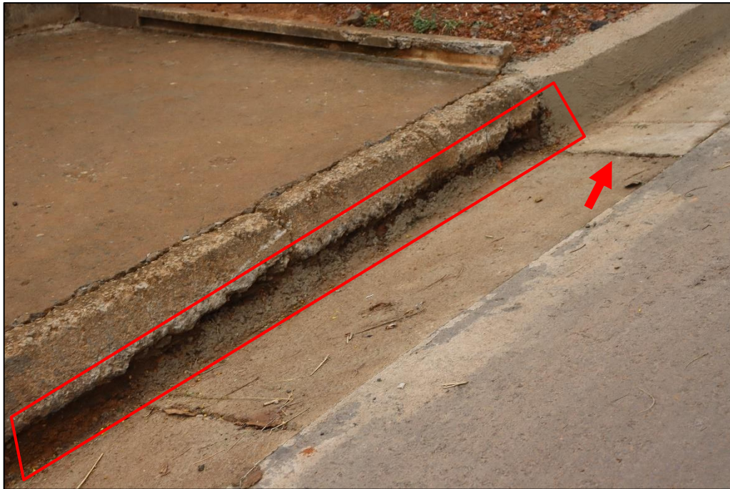
Figura 45 - Ausência de acabamento no meio-fio do passeio. Juntas irregulares entre uma sarjeta e outra, possibilitando a entrada de água debaixo do passeio.
