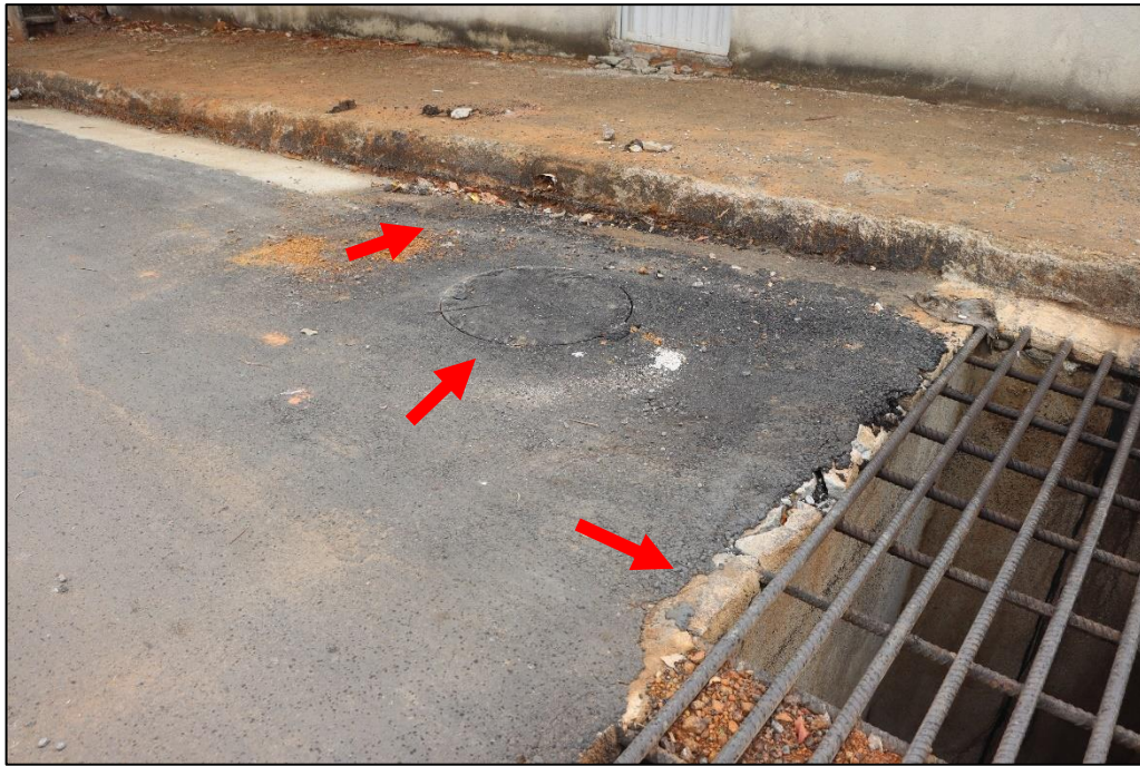
Figura 25 - A tampa do poço de visita e a sarjeta foram cobertas pela pavimentação asfáltica. Degradação do revestimento asfáltico próximo à grelha da canaleta.
