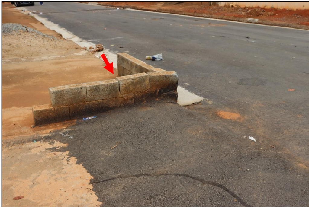
Figura 37 - Estrutura de contenção de alagamentos no passeio. Blocos sem revestimento e com quantidade insuficiente de argamassa nas juntas de assentamento.
