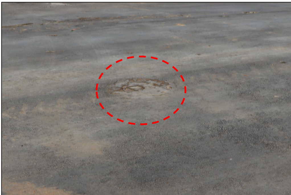
Figura 18 – Parte da tampa de um poço de visita foi tamponada pela pavimentação asfáltica. Irregularidade na planicidade do pavimento.
