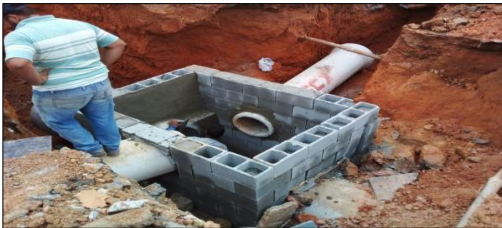
Figura 102 – Execução dos poços de visita, ausência de argamassa de assentamento e desnivelamento de alguns blocos de concreto. Fonte: relatório fotográfico das medições da FFX.
