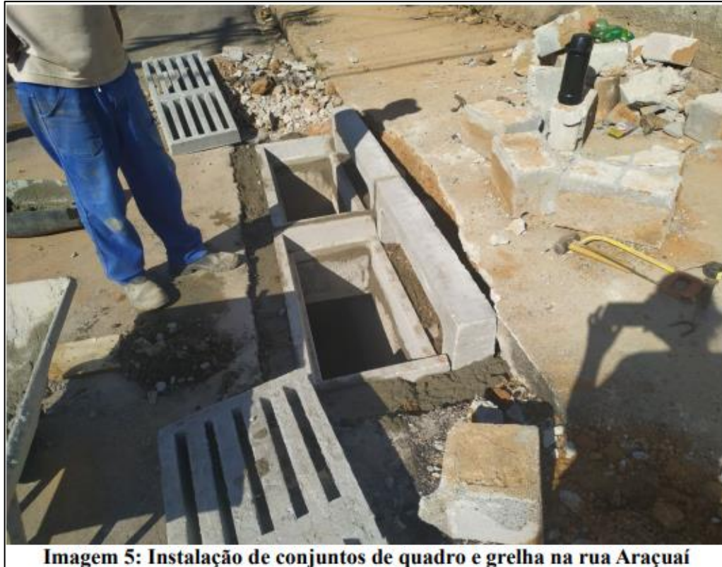
Figura 61 – As caixas da boca de lobo foram executadas mais altas que greide da pista, sendo necessário demolir a última fiada de blocos de concreto. Fonte: relatório fotográfico medição FFX nº 7.
