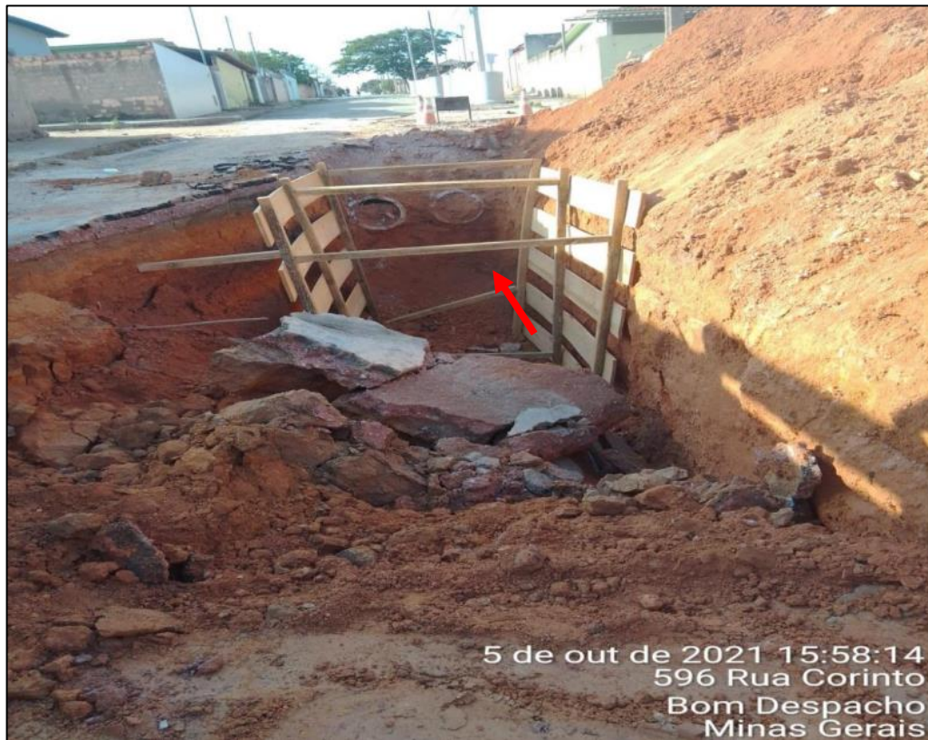
Figura 108 – Contenção insegura do solo. Fonte: relatório fotográfico da primeira medição da adesão 09/2021 em 05/10/2021.
