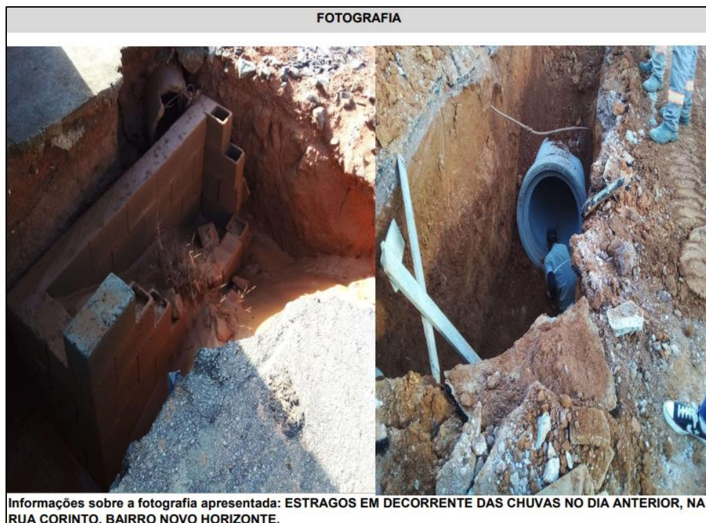
Figura 58 – A existência do escoramento das laterais da vala reduziria os estragos ocorridos na drenagem pluvial bem como o retrabalho para limpeza do solo erodido. Fonte: relatório fotográfico da terceira medição da adesão 09/2021 em 04/03/2022
