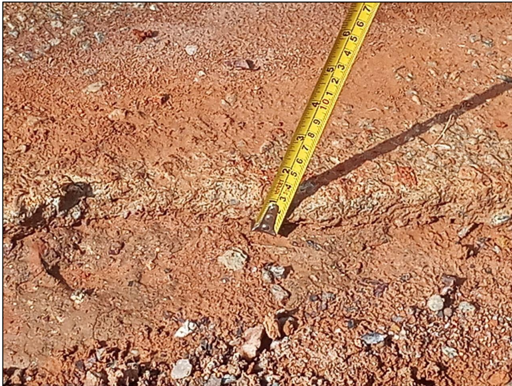
Figura 70 - Aproximação da figura anterior. Sarjeta com espessura de cerca de 2 cm.
