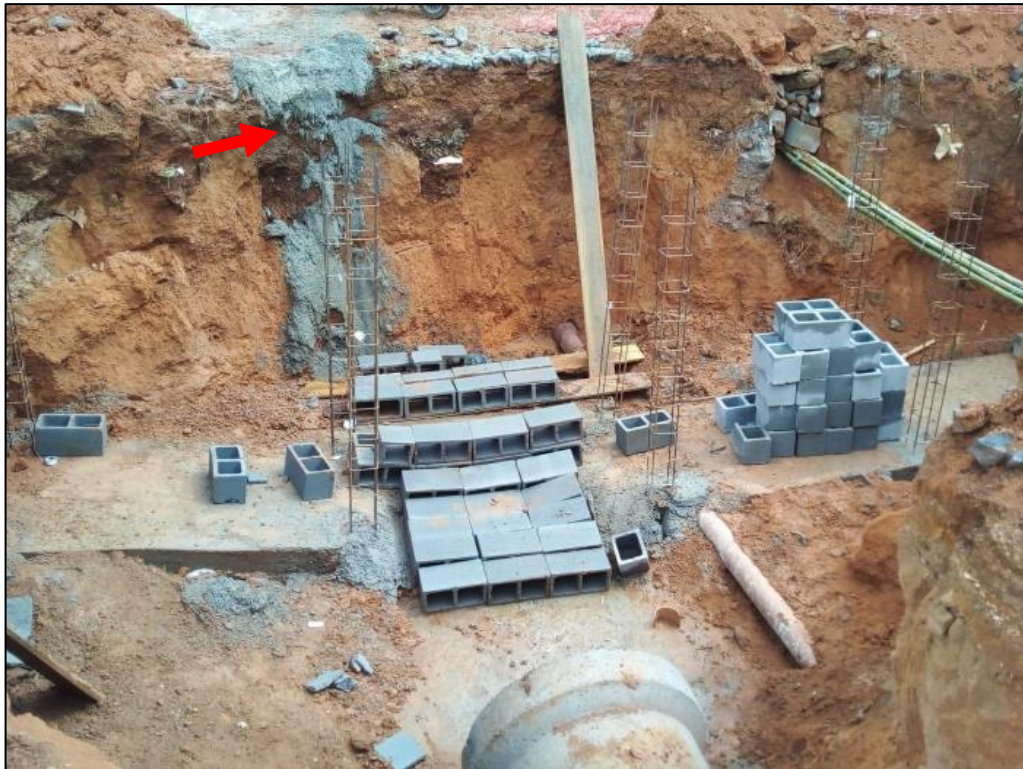
Figura 57 – Concreto escorrendo na lateral da vala. Ausência de escoramentos e contenção do solo. Fonte: relatório fotográfico da segunda medição da adesão 09/2021 em 02/02/2022.
