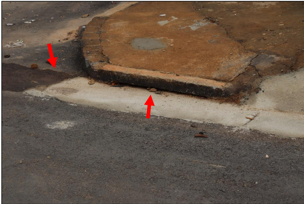
Figura 39 - Descontinuidade da sarjeta e abertura entre o meio-fio e sarjeta.
