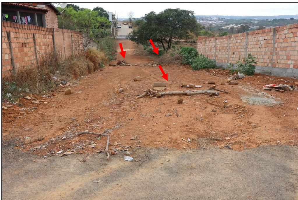
Figura 24 - Vista da rua Almenara que não possui pavimentação asfáltica, passeio e sarjetas. Presença de entulhos e crescimento de vegetação na rua.
