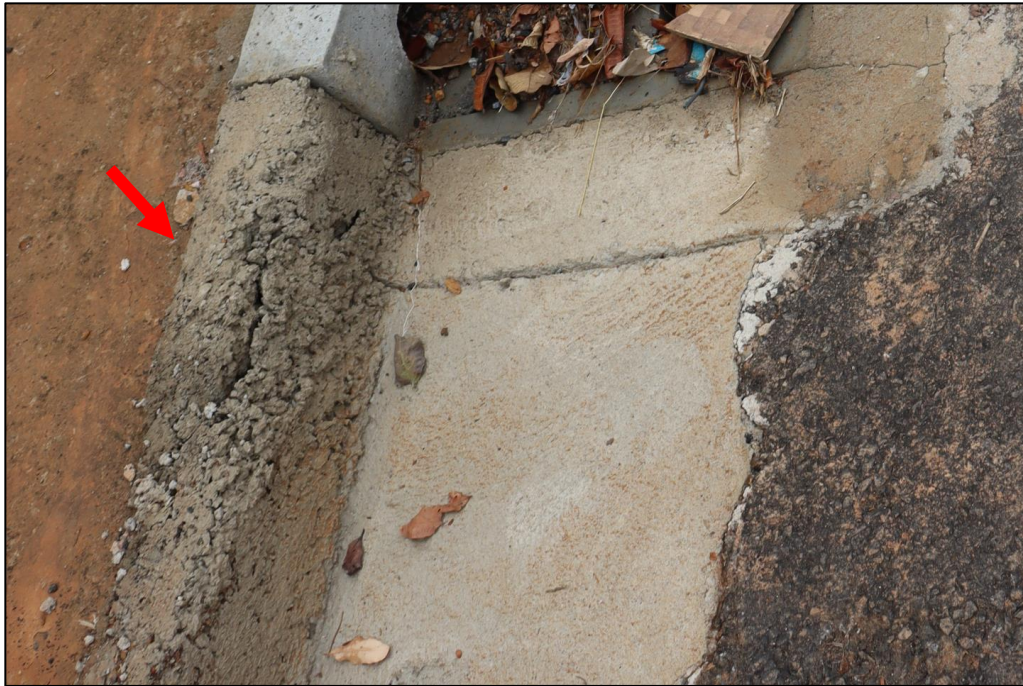
Figura 87 – Meio-fio concretado apresentando falhas e segregação de agregados. Imagem da diligência 22 de setembro.
