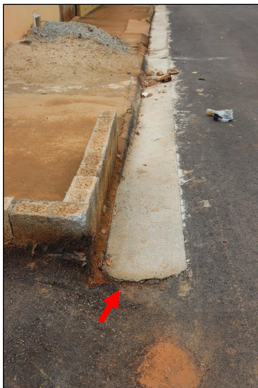
Figura 38 - Ausência de acabamento e descontinuidade da sarjeta.
