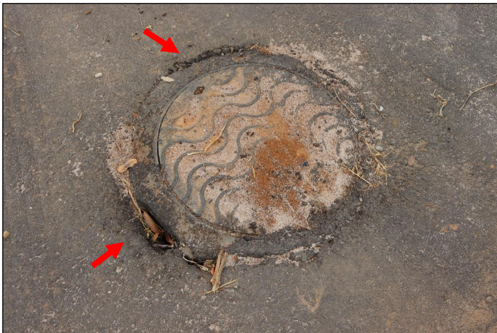
Figura 36 - Aberturas no entorno da tampa do poço de visita devido a falha de acabamento.
