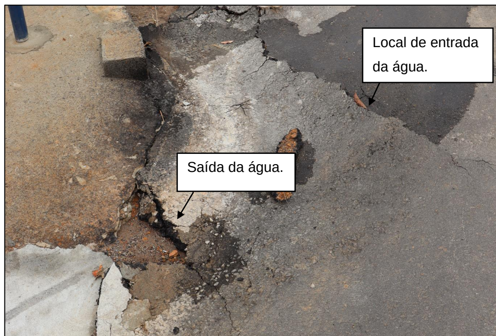
Figura 34 - Aproximação da figura anterior. A água está percolando pela fratura e caminhando na parte inferior do pavimento asfáltico, descolando-o da base.
