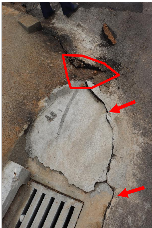
Figura 32 - O concreto da sarjeta está solto e se movimentou devido a passagem de umidade. Observa-se também falha na pavimentação asfáltica do local destacado em vermelho e abertura entre o concreto do entorno da boca de lobo e o pavimento asfáltico.
