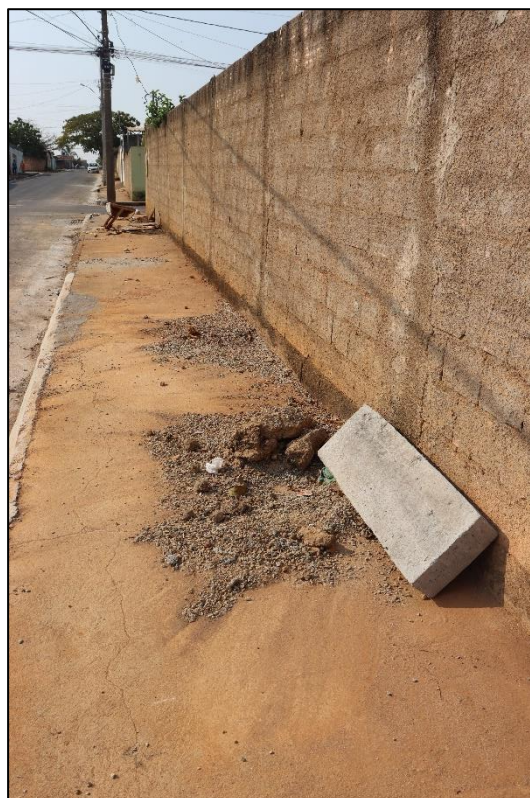
Figura 7 – Restos de materiais de construção utilizados na pavimentação depositados no passeio da rua Corinto.
