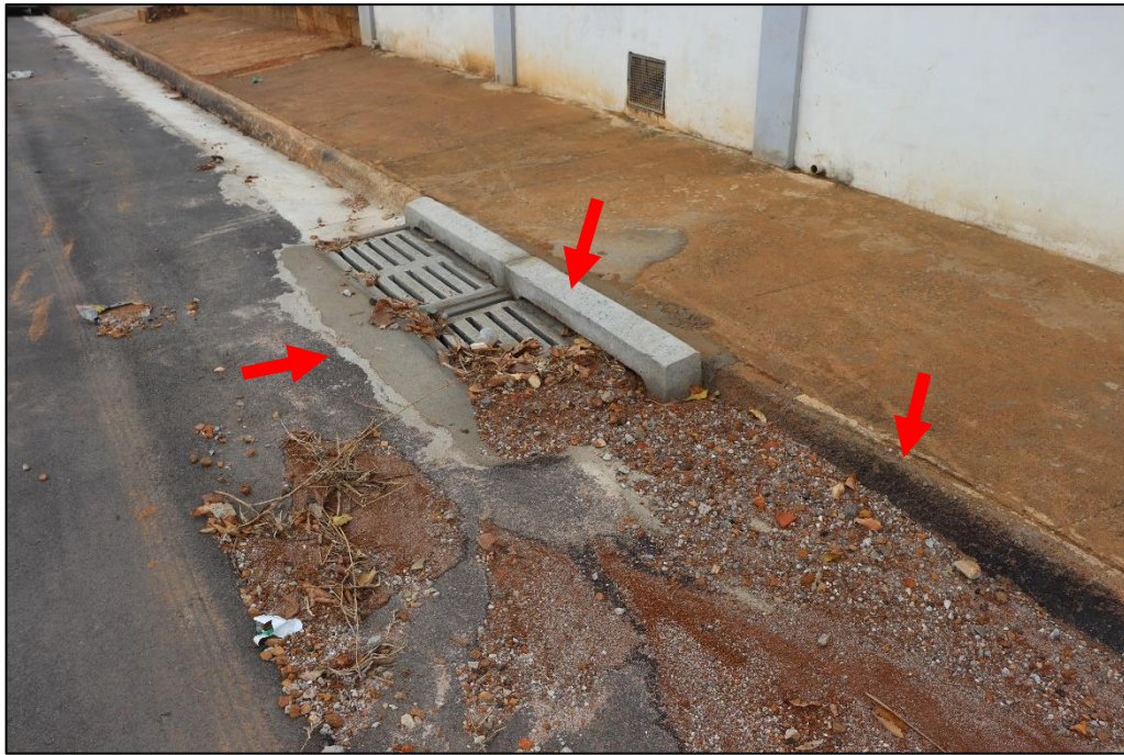
Figura 23 - Presença de terra, folhas e entulhos na sarjeta e grelha da boca de lobo carreadas dos passeios não pavimentados e dos lotes lindeiros pelas águas da chuva. Observa-se também concreto com variação na coloração, indicando recente intervenção no entorno da boca de lobo.
