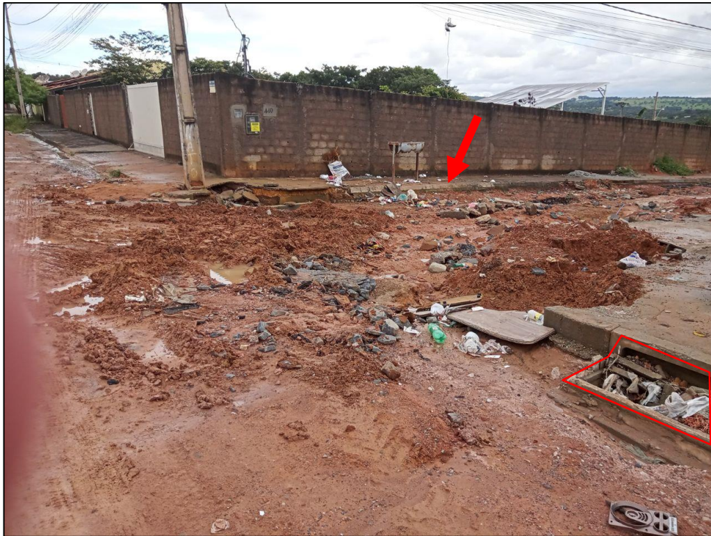
Figura 63 - Vista ampla do local da figura anterior. Nota-se a presença de entulhos e lixo na via. Nota-se também que a boca de lobo está preenchida com terra, entulhos e lixo.
