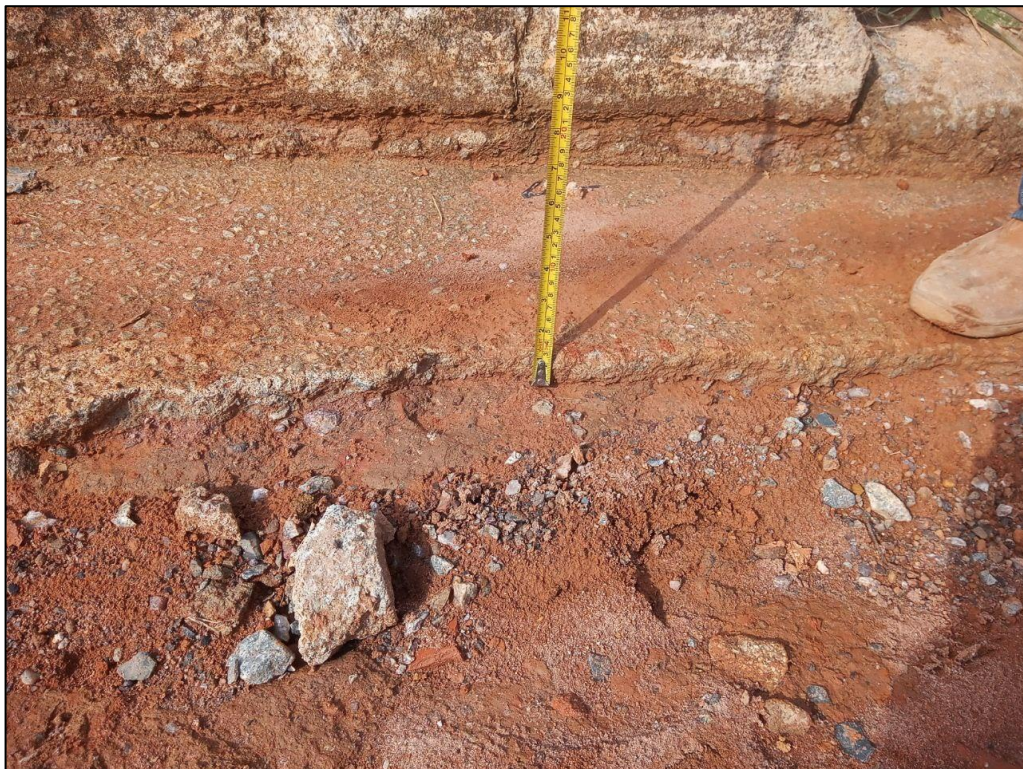
Figura 69 - Medição da espessura da sarjeta de forma a compreender a espessura do revestimento asfáltico perdido.
