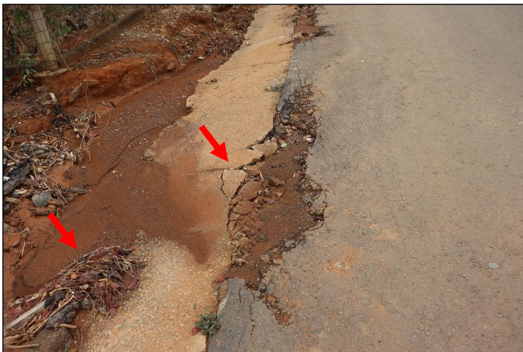
Figura 20 - Aproximação do local da figura anterior. As fraturas e fissuras são causadas pela passagem de umidade no encontro entre a sarjeta e o pavimento asfáltico. Nota-se também a existência de vegetação e entulhos na sarjeta.
