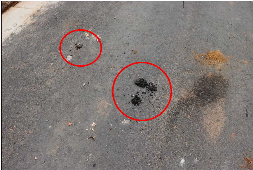
Figura 27 - Fragmentos da pavimentação asfáltica soltos carregados pela chuva.
