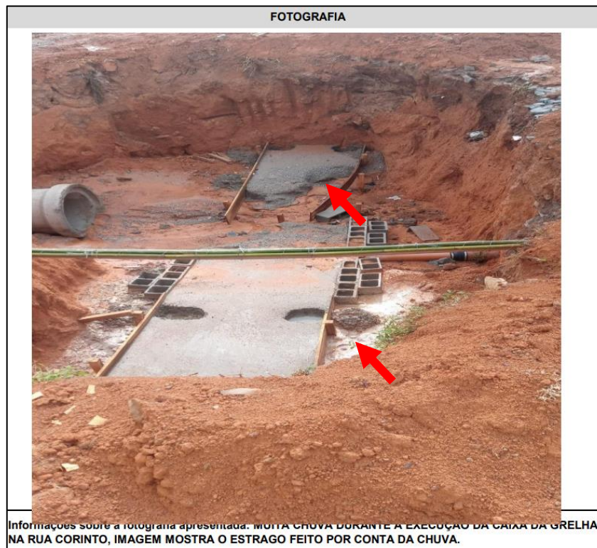
Figura 56 – O concreto utilizado na execução da caixa da grelha foi carreado pela água da chuva. Data da execução dos serviços planejada inadequadamente em função do período chuvoso previsto. Fonte: relatório fotográfico da segunda medição da adesão 09/2021 em 31/01/2022.
