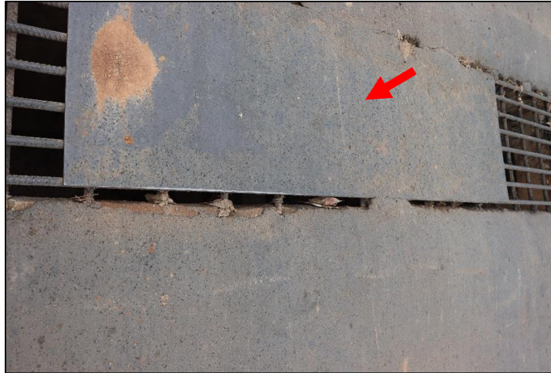
Figura 96 – Chapa metálica sobre a grelha da canaleta de coleta pluvial. Este tamponamento impossibilita a captação total do volume de água que chega na canaleta. Imagens da diligência de 22 de setembro.
