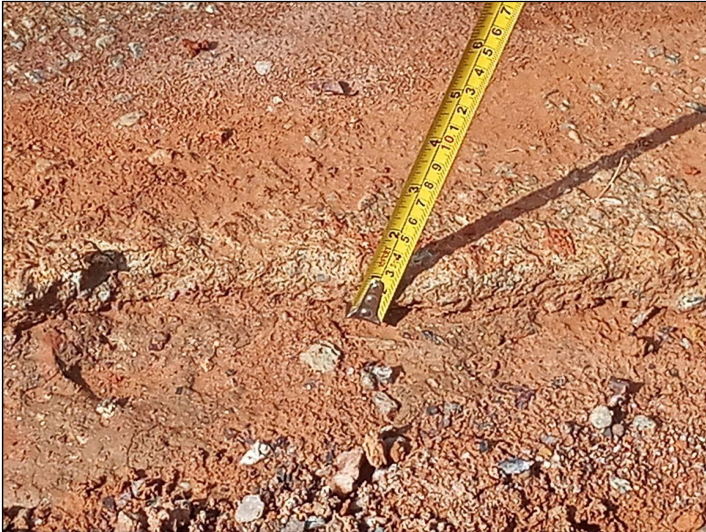
Figura 80 – Espessura da sarjeta de aproximadamente 3 centímetros. Fonte: Imagens enviadas pelo vereador Éder Tipura.
