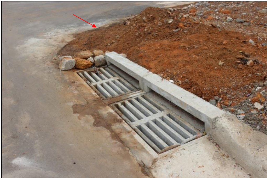
Figura 98 – Grelha executada em concreto, ausência de meio fio e sarjeta. Fonte: Diligência 22 de setembro.
