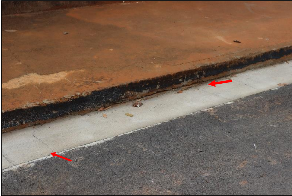
Figura 83 – Ausência de inclinação. Frisos com abertura superficial simulando juntas de movimentação. Fissuração característica de retração do concreto e abertura entre meio-fio e sarjeta. Fonte: diligência 22 de setembro.
