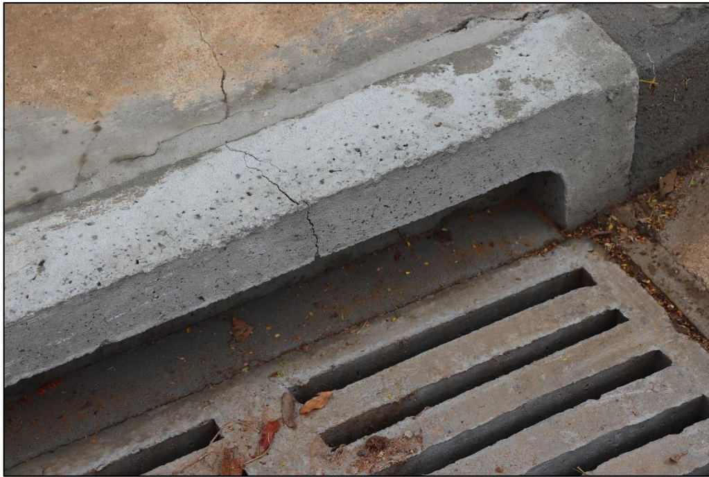
Figura 41 - Fissura elemento de concreto.
