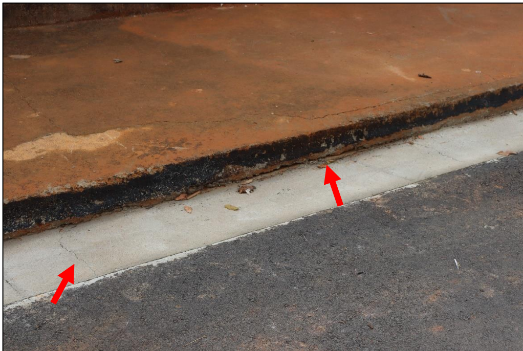
Figura 44 - Abertura na extremidade entre a sarjeta e o meio-fio permitindo o acesso de água para debaixo do passeio. Fissura na sarjeta.
