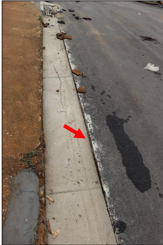
Figura 29 - Diferença de nível entre a sarjeta e o pavimento asfáltico decorrente da ausência de nivelamento durante a concretagem da sarjeta. Resíduos de pavimento asfáltico carreados pela chuva e depositados próximo à boca de lobo.
