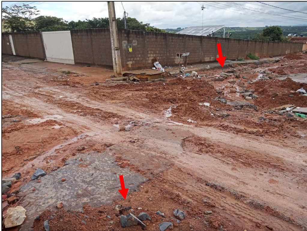
Figura 62 - Vista da rua Corinto após as chuvas. Via danificada e difícil trânsito, com grande parte da pavimentação asfáltica removida pelas chuvas.
