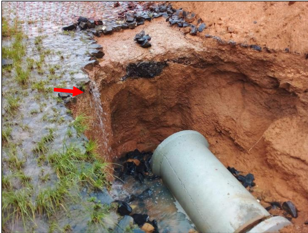
Figura 55 – Chuvas durante o período de aplicação das tubulações de drenagem paralisaram as obras. Data da execução dos serviços planejada inadequadamente em função do período chuvoso previsto. Fonte: Retirada do relatório fotográfico da segunda medição da adesão 09/2021 em 07/01/2022.
