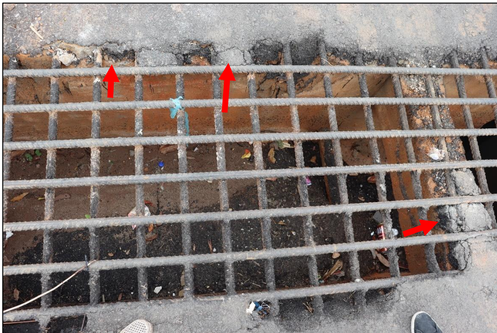
Figura 16 – Acúmulo de sujidades do interior da canaleta e ausência de acabamento no entorno da grelha. Fissuras e fratura no revestimento asfáltico localizado na fixação da grelha. No interior da caixa de captação é possível verificar acúmulo de resíduo de massa asfáltica, diminuindo sua capacidade coletora.
