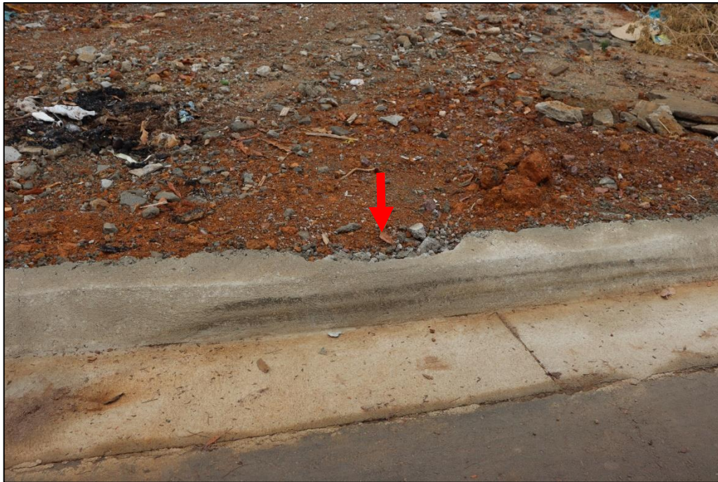
Figura 47 - Falha na concretagem do meio-fio.
