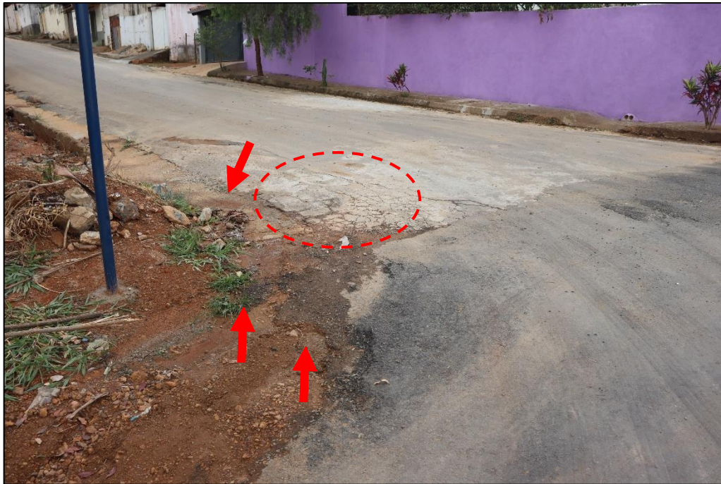
Figura 17 – Emenda da pavimentação antiga com a nova. Ausência de meio-fio no passeio, fissuras e ausência de acabamento na pavimentação asfáltica. Rebaixamento, fratura, fissuras e descontinuidade da sarjeta. Nota-se também o crescimento de vegetação entre a pavimentação asfáltica e a sarjeta.
