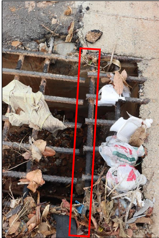
Figura 15 - Aproximação da grelha da figura anterior. As barras da grelha estão descontinuas.
