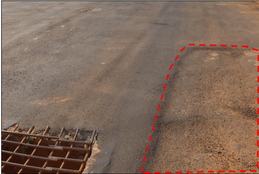
Figura 3 - Abaulamento no pavimento próximo à caixa coletora de drenagem.
