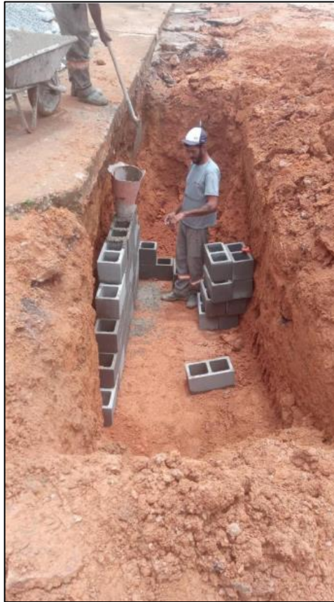
Figura 90 – Blocos de concreto instalados diretamente no solo, empilhados, sem argamassa de assentamento. Fonte: Retirada do relatório fotográfico da primeira medição da adesão 09/2021 em 02/11/2021.
