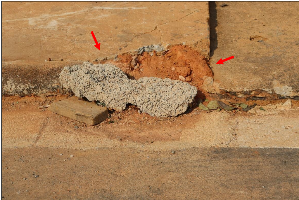
Figura 6 - Fratura e fissuras no meio-fio.
