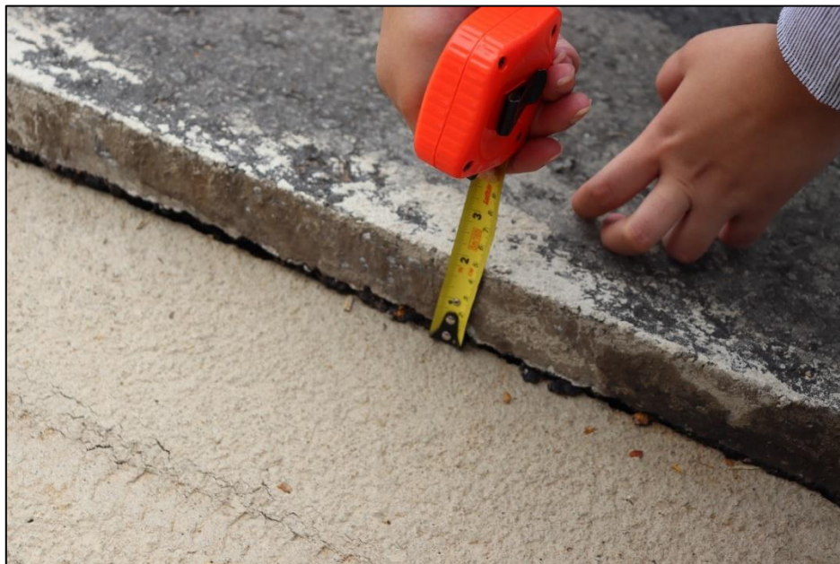
Figura 30 - Aproximação da figura anterior. A superfície do pavimento está à cerca de 5 cm acima da sarjeta.
