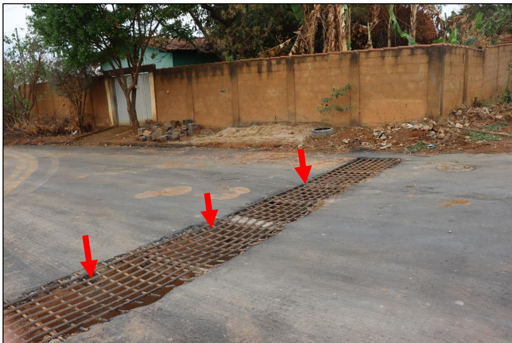
Figura 9 – Grelha da canaleta localizada na rua Corinto parcialmente embutida e parcialmente solta na pavimentação asfáltica de borda. Deformação das barras de aço da grelha em decorrência do trânsito de veículos. Acúmulo de resíduos em partes da grelha.
