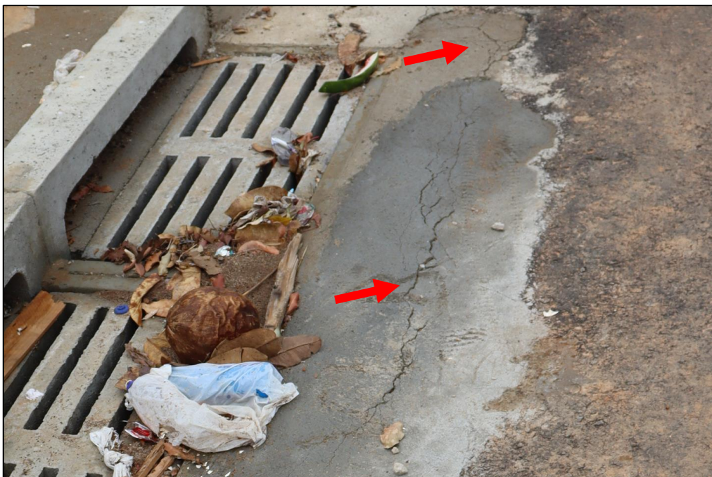
Figura 40 - Concreto com coloração indicativa de recente aplicação acometido por fissuras características de retração do concreto.
