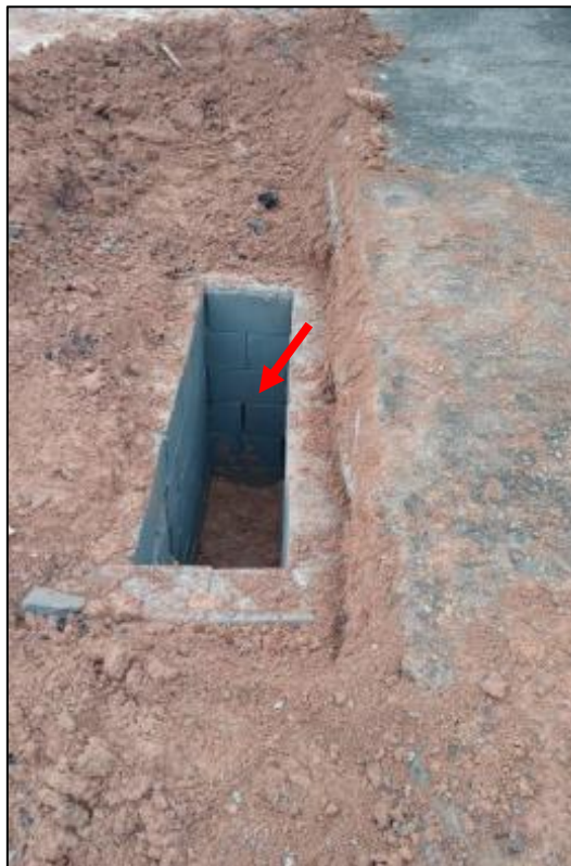
Figura 89 – Execução da boca de lobo dupla na rua Corinto, ausência de preenchimento de juntas verticais com argamassa na alvenaria. Fonte: Relatório Fotográfico referente a segunda medição para construtora FFX.
