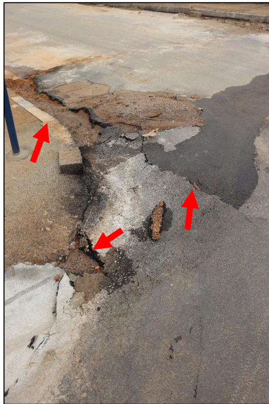
Figura 33 - Fratura na pavimentação asfáltica e ausência de sarjeta no ponto rebaixado próximo ao meio-fio.
