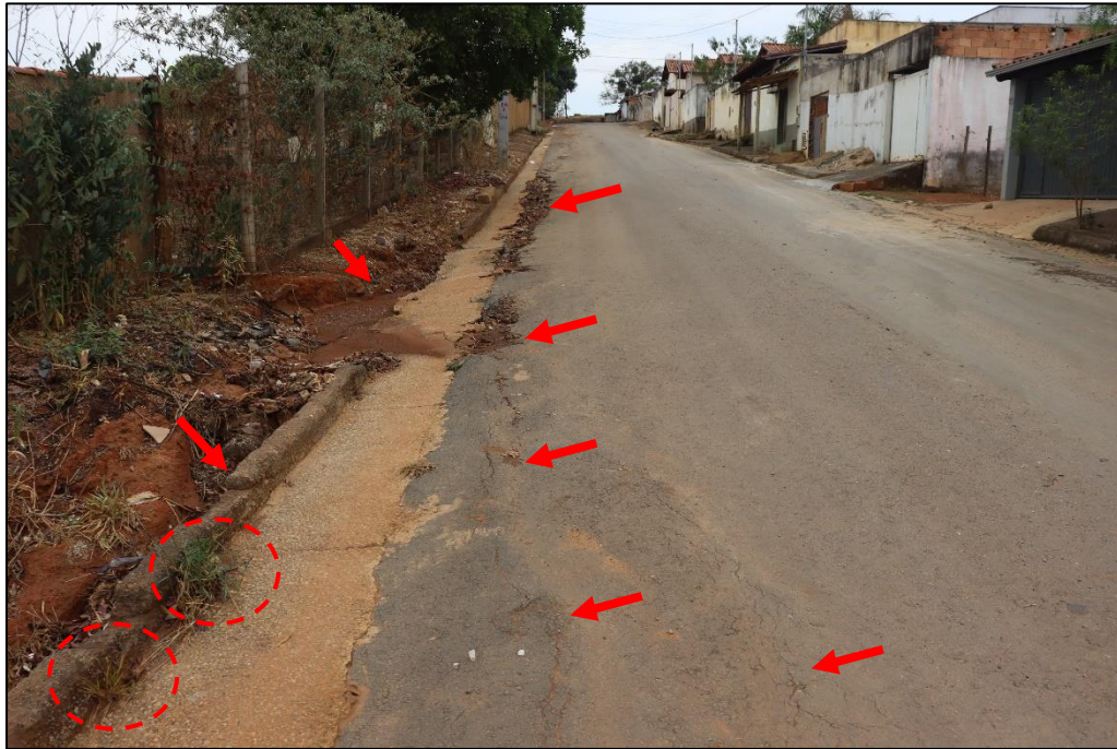
Figura 19 – Descontinuidade e ausência de acabamento em alguns pontos do meio-fio, fraturas e fissuras em diversos pontos no pavimento da rua Corinto. Crescimento de vegetação entre a sarjeta e meio-fio.
