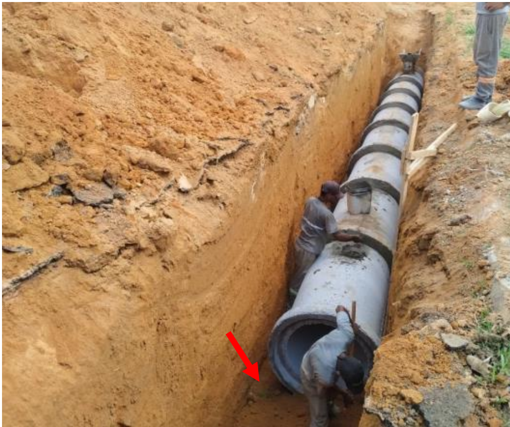
Figura 107 – Execução do rejuntamento dos tubos, instalação em solo não compactado e ausência de berço de concreto abaixo do manilhamento. Ausência de escoramento par contenção do solo no entorno das valas Fonte: Relatório Fotográfico das medições da FFX.
