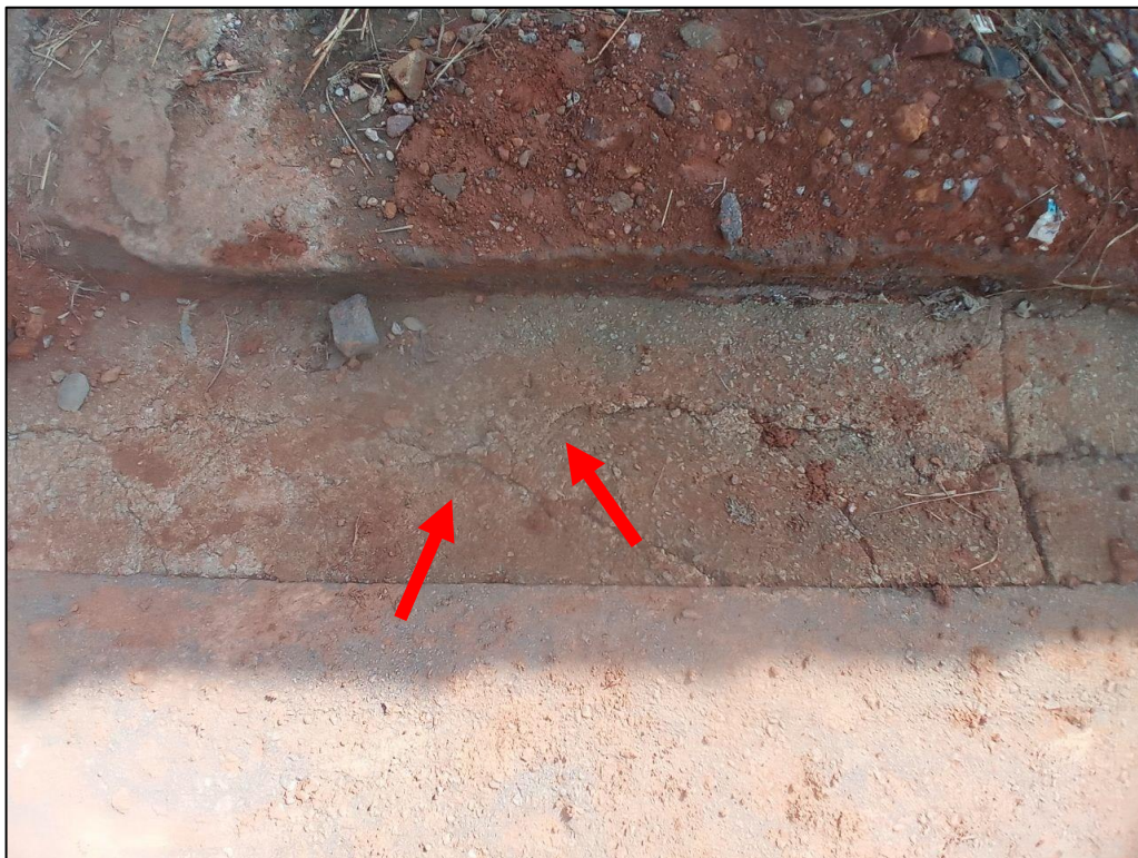
Figura 67 - Fissuras e abaulamento na sarjeta.
