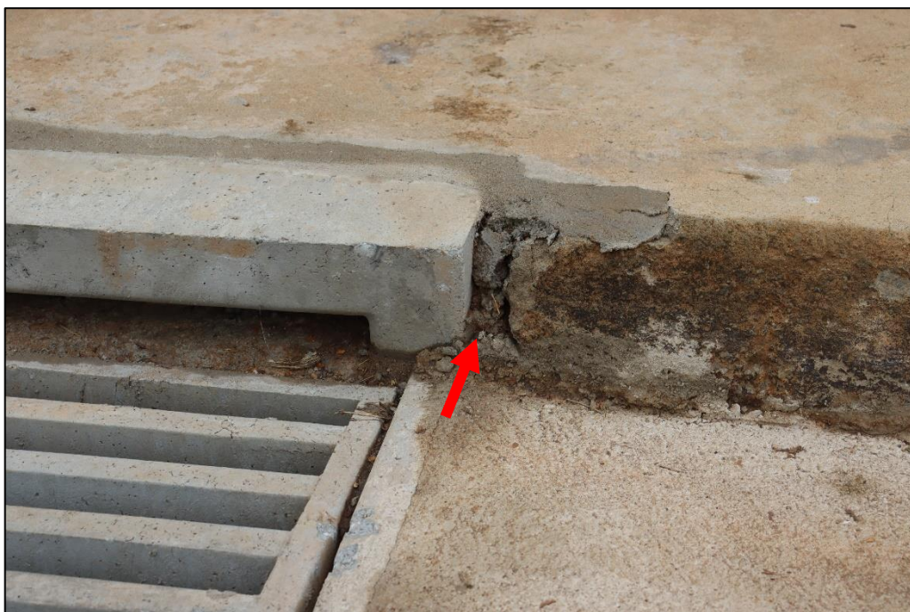
Figura 46 - Ausência de acabamento no meio-fio.
