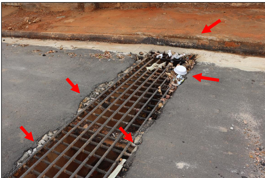
Figura 14 - Emulsão asfáltica no meio-fio e presença de folhas e lixo transportados pela água da chuva sobre a grelha da canaleta. Fraturas no revestimento asfáltico do entorno da canaleta.
