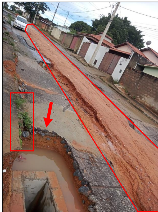
Figura 64 - Pavimentação asfáltica parcialmente removida expondo a base. No centro da pista o revestimento foi completamente removido pelas chuvas. Observam-se também crescimento de vegetação próximo ao meio-fio e dispositivo de drenagem completamente exposto, sem acabamento e grelha de proteção, com presença de água em seu entorno devido ao rebaixamento do solo.
