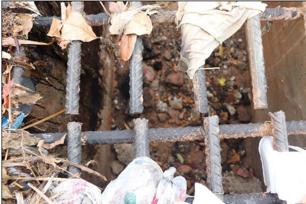
Figura 95 – Barras sem qualquer tipo de fixação. Fonte: Diligência 22 de setembro.
